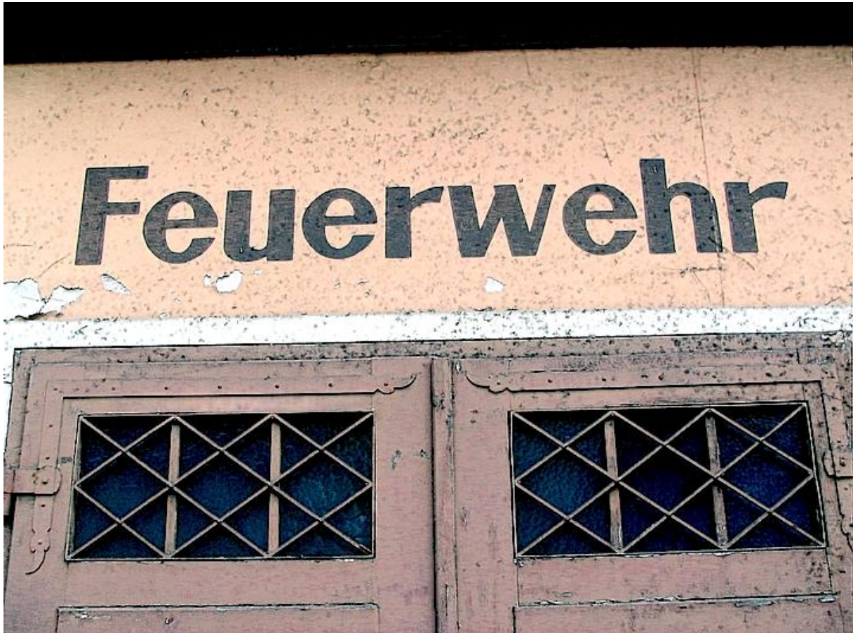
Von Altersschwäche gezeichnet ist das Feuerwehrgerätehaus Riedlingen. Foto: Ines Bode
