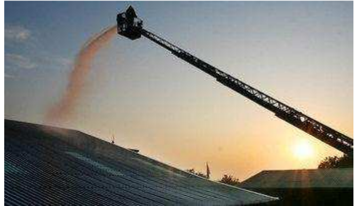
Der Wenderohreinsatz der Drehleiter ist nur mit Wasserversorgung aus der Pumpstation oder dem Erdtank möglich. | Foto: Michael Raab
